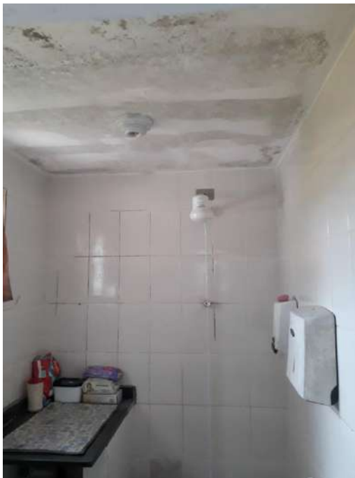
Presença de área de infiltração e mofo no teto em um dos banheiros destinados às crianças.
