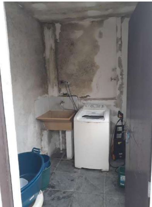
Lavanderia com infiltração nas paredes e teto.
