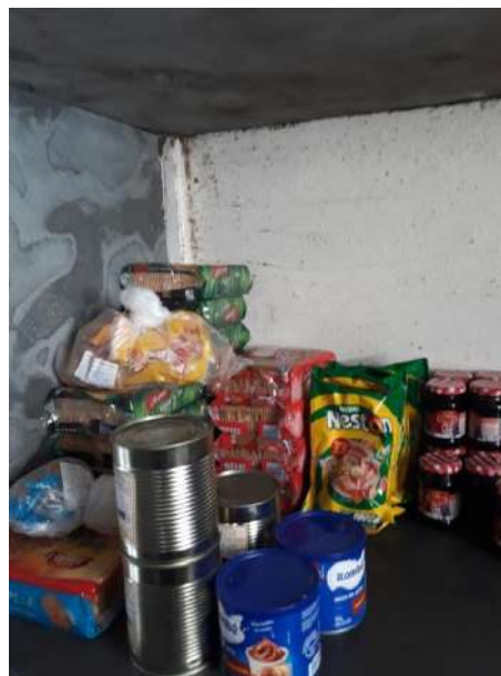
Alimentos estocados em área que apresenta ferrugem e mofo
