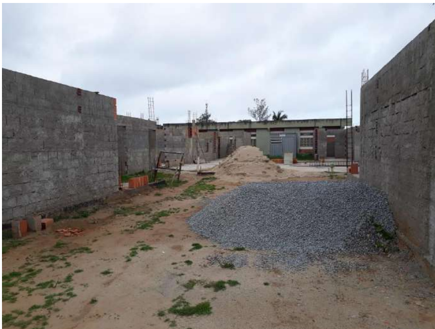
Imagem 04 – Obra atrasada – Materiais de construção mal acondicionados e sem segurança.
