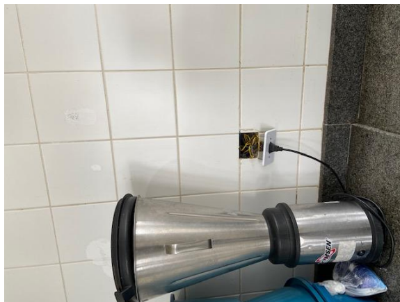
Instalação elétrica mal conservada
