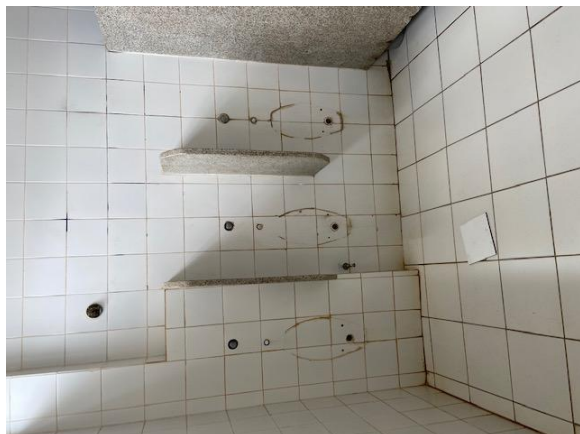
Falta de Mictórios
