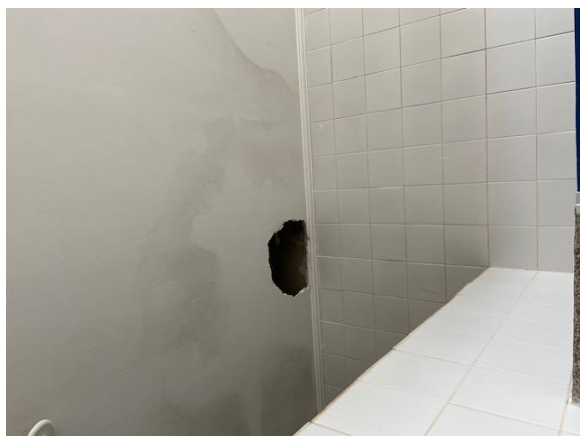
Buraco no teto do banheiro
