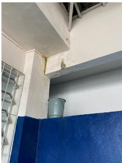
Teto com infiltração e goteira.
