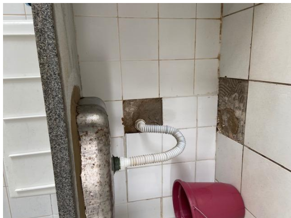
Cerâmicas danificadas na cozinha
