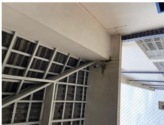
Teto com mofo
