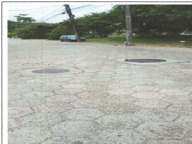
Foto Nº 2 DESLOCAMENTO DOS BLOQUETES RUA PEDRO AMÉRICO/RUA FELICIO LIMA.
