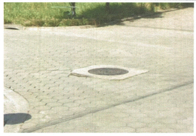
Foto Nº 6 SOLAPAMENTO EM VOLTA DO PV RUA PEDRO AMÉRICO/RUA PLÁCIDO LOUZADA.
