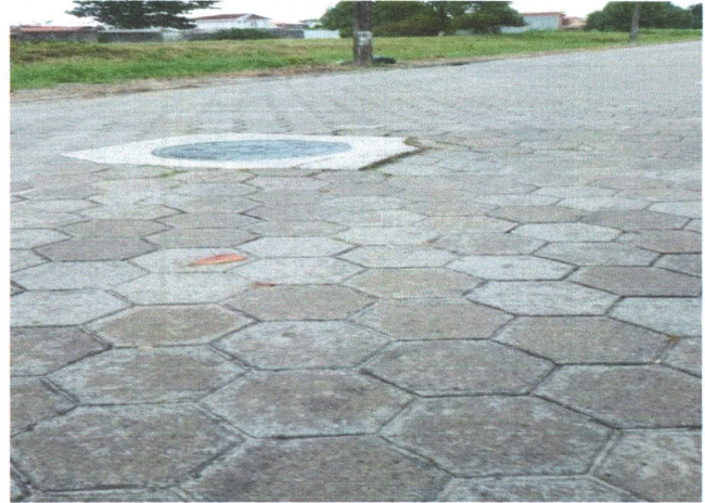
Foto Nº 10 SOLAPAMENTO EM VOLTA DO PV RUA PEDRO AMÉRICO/RUA MARIA CANDIDA CAMPOS ARAGÃO.
