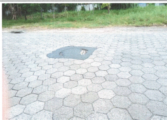
Foto Nº 3 SOLAPAMENTO EM VOLTA DO PV RUA PEDRO AMÉRICO/RUA ZEFERINO DA COSTA.
