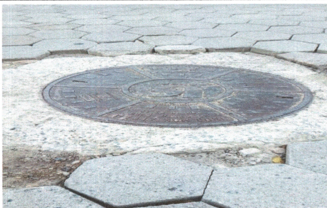
Foto Nº 11 SOLAPAMENTO EM VOLTA DO PV RUA PEDRO AMÉRICO/RUA LUCÍLIO DE ALBUQUERQUE.
