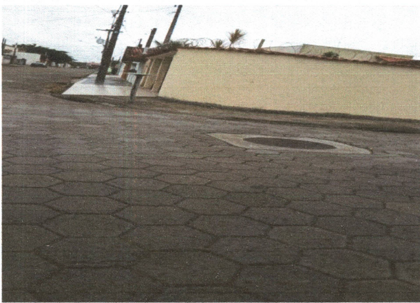
Foto Nº 5 SOLAPAMENTO EM VOLTA DO PV RUA PEDRO AMÉRICO/RUA PLÁCIDO LOUZADA.
