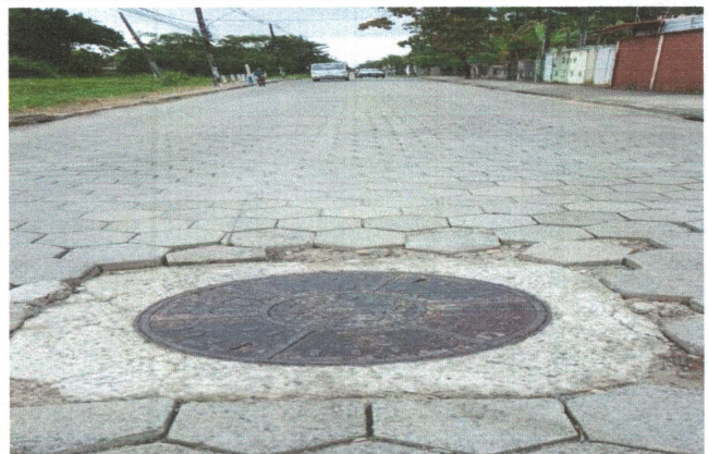
Foto Nº 12 NECESSÁRIO O NIVELAMENTO DO PV. RUA PEDRO AMÉRICO/RUA LUCÍLIO DE ALBUQUERQUE.
