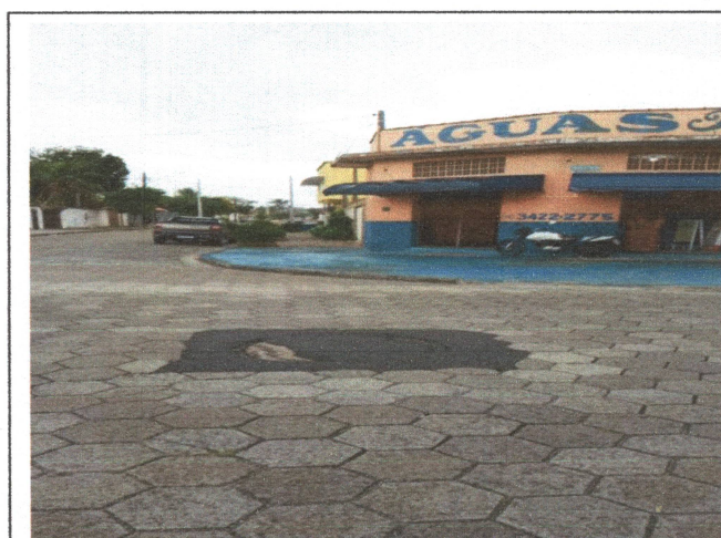
Foto Nº 4 DESLOCAMENTO DOS BLOQUETES RUA PEDRO AMÉRICO/RUA ZEFERINO DA COSTA.
