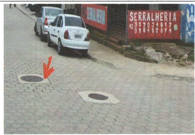
Foto Nº 8 SOLAPAMENTO EM VOLTA DO PV RUA PEDRO AMÉRICO/RUA HENRIQUE BERNADELI.
