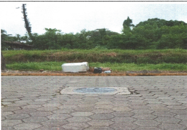
Foto Nº 7 SOLAPAMENTO EM VOLTA DO PV RUA PEDRO AMÉRICO/RUA HENRIQUE BERNADELI.
